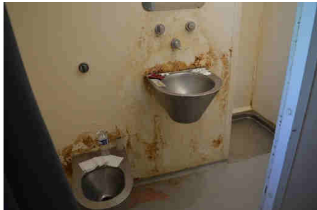
La rouille et la moisissure prolifèrent sur les murs des salles de bain du CRA 1. Photo : Marie Allenou/Rue89Lyon
