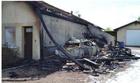
Il ne reste plus rien de cet appentis où stationnait une voiture entièrement calcinée par les flammes. Photo Henri Barth
