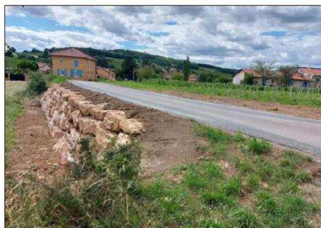
Les travaux d'enrochement réalisés sur la départementale 607 sont terminés. Photo Progrès/Catherine LAPOSTOLET
