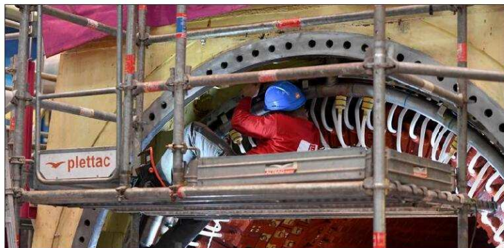
L'unité de production n°2 de centrale avait été découplée du réseau électrique le 18 janvier 2020.
